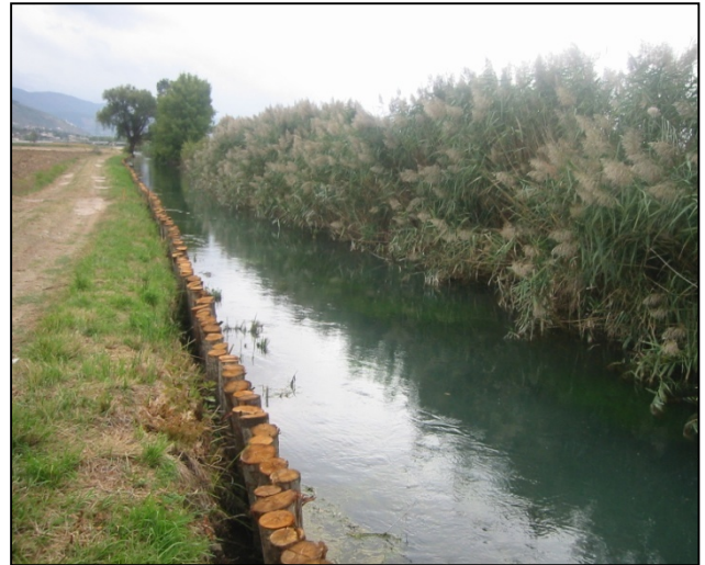
Fig. 5.4.3.18 - Esempio di sponda fluviale priva di vegetazione riparia in cui è stata realizzata una palizzata.
