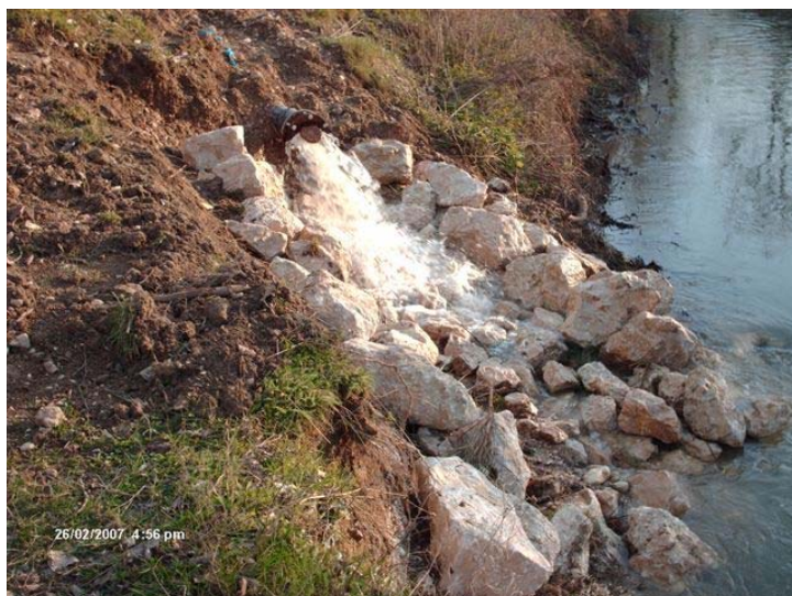
Fig. 6.1.1 – Nuovo scarico dello stabilimento Umbra Olii, recapitante nel Marroggia .
